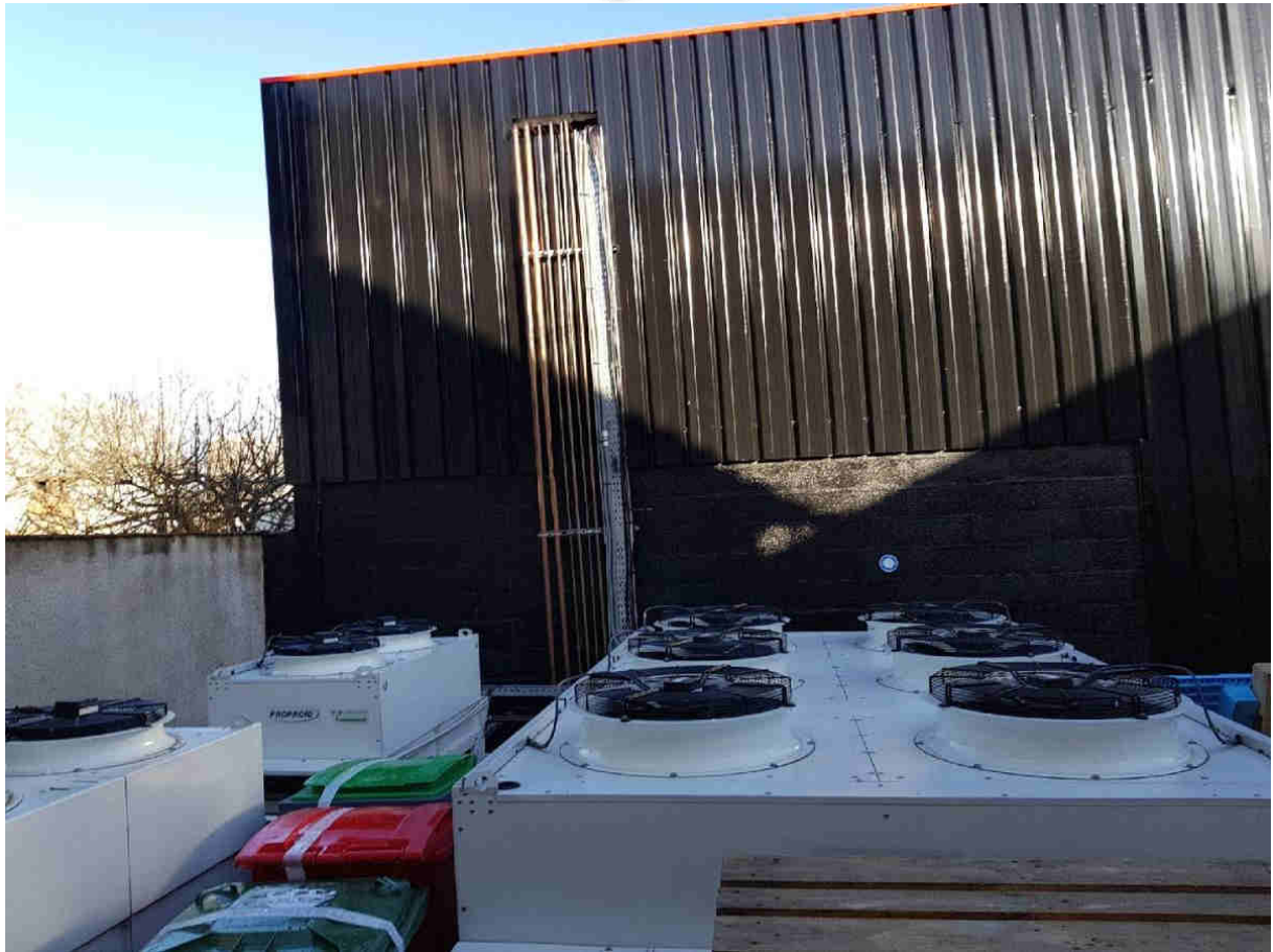
L'ensemble des blocs condenseurs au sol en arrière du bâtiment.
